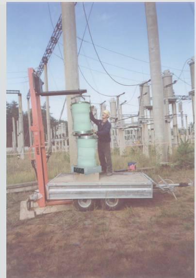
Aufbau eines mobilen Prüftransformators
